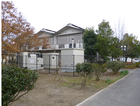
<嵯峨・自家発電設備>
